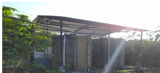
Figura 4: Tanques de almacenamiento de agua.
